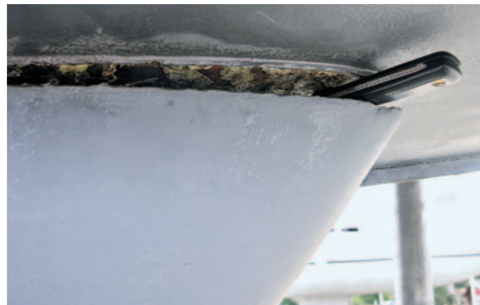
▲ Wenn die Yacht in voller Fahrt auf einen Stein fährt, gibt das Laminat im Kielbereich nach, und die Bolzen reißen heraus
